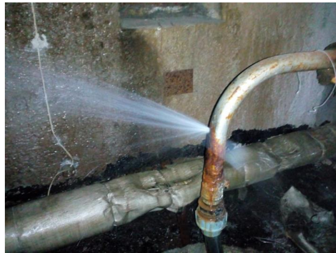
имеется течь из котла
