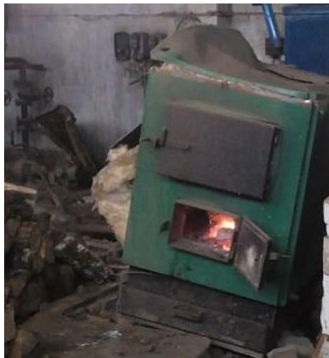
имеется механическое повреждение корпуса котла
