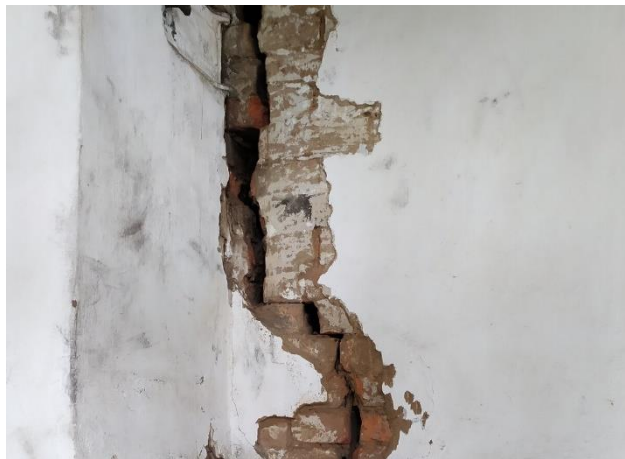
имеется сквозная трещина в печи
